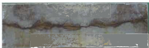
写真-8 共通試験における劣化グレードⅡ
