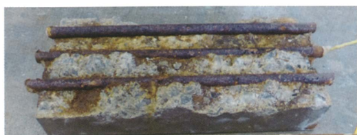
写真-9 共通試験における劣化グレードⅢ
