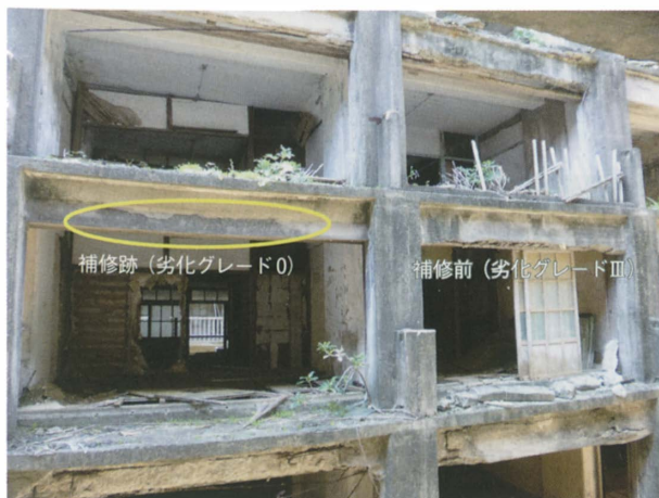
写真-5 日給社宅における剥落部と補修部
